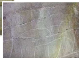
下部工のひび割れ
