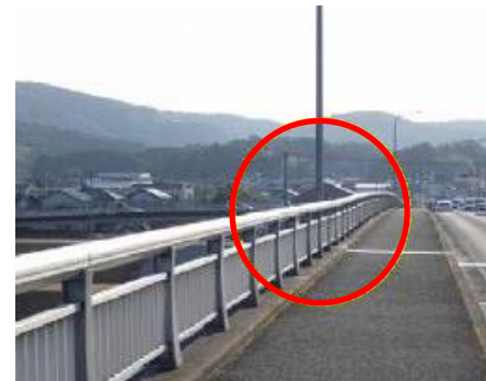
▲中央ヒンジ部の垂れ下がり
