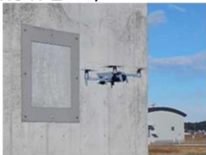
ドローンによる損傷把握
