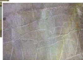
下部工のひび割れ
