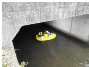
水上ドローンによる損傷把握
