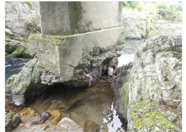
地方自治体管理 橋脚洗掘
