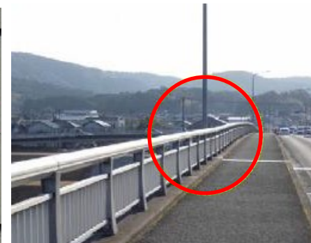
▲中央ヒンジ部の垂れ下がり
