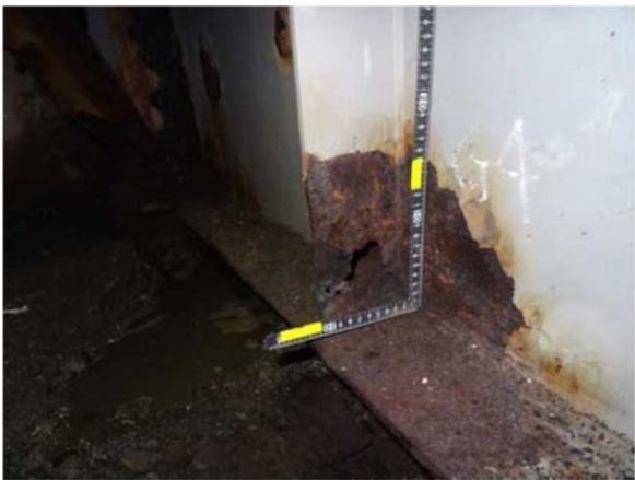
国管理 主桁腐食・欠損
