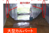
▲大手カルバート ▲継手からの土砂流出
