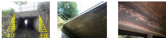
▲溝橋 変状項目
