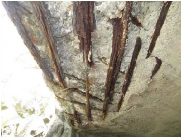
国管理 床版鉄筋露出 ※床版：橋の裏側
