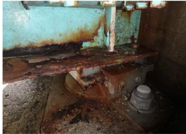
地方自治体管理 主桁腐食
