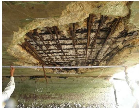
地方自治体管理 床版鉄筋露出
