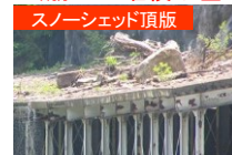
▲崩土等の堆積
