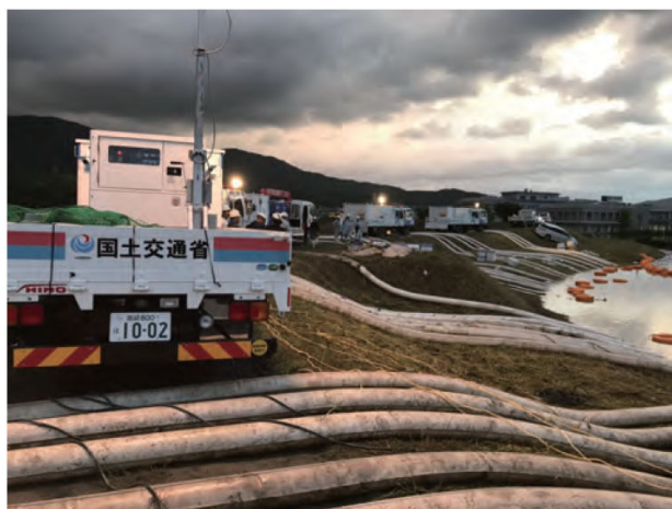
▲吸い込み口側の状況
