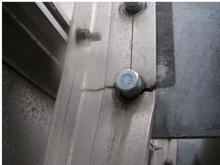
き裂損傷 (車両衝突)
