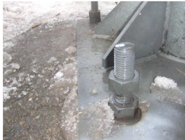
ボルトの緩み (施工不良)
